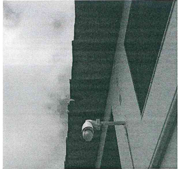
2. Vista do telhado – telha quebrada.
