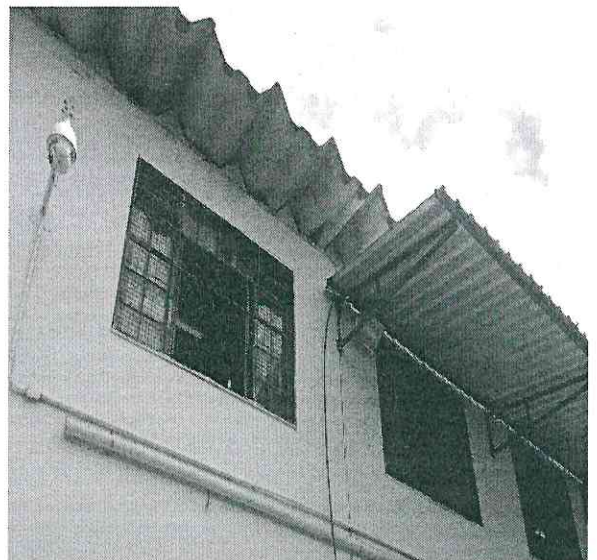
4. Telhado parcialmente arrancado pelas chuvas – lado direito.
