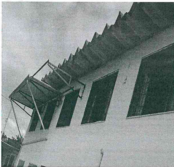
3. Telhado parcialmente arrancado pelas chuvas – lado esquerdo.
